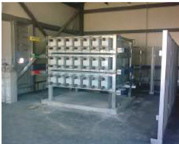
БСК-6,3-9,2 УХЛ1, подстанция «Майя»
