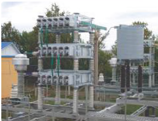
БСК-110-40 УХЛ1, подстанция «Субханкулово»
