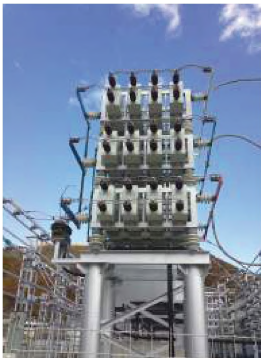
БСК-12,64-7,2 УХЛ1, подстанция «Горелое»
