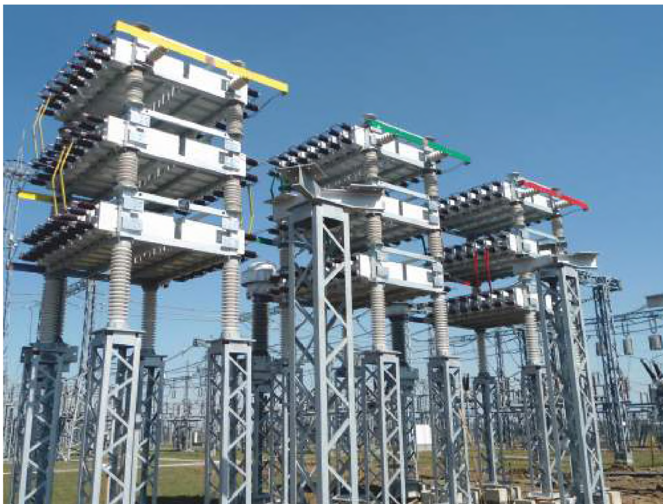
БСК-110-52 УХЛ1 производства ТОО «УККЗ», подстанция 330 кВ «Фрунзенская»
