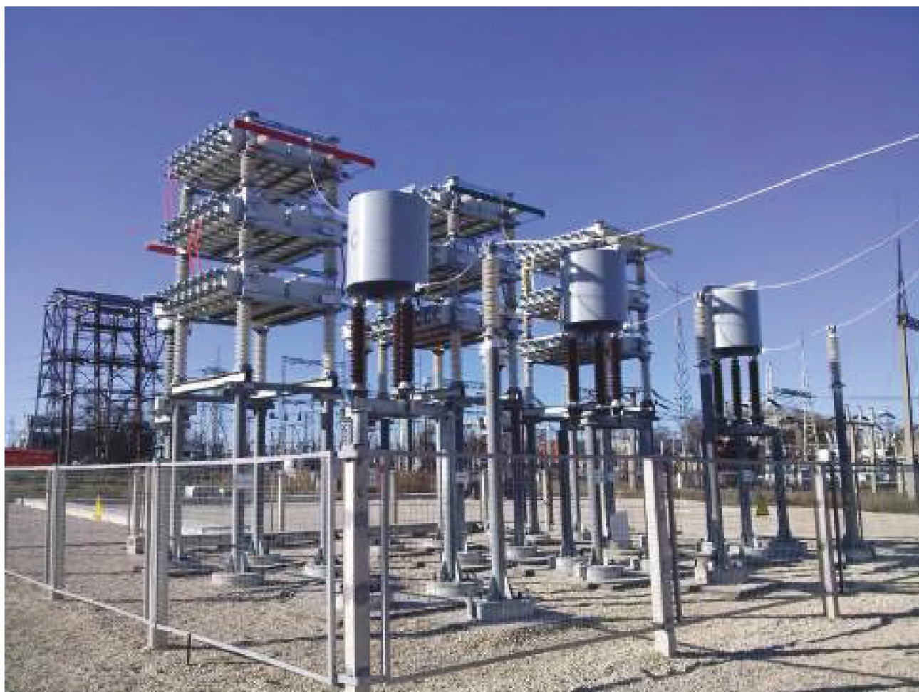
БСК-110-52 УХЛ1 производства ТОО «УККЗ», подстанция 220 кВ «Тула», г. Тула
