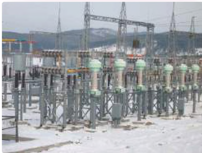
БСК-110-26 УХЛ1, подстанция «Татаурово»
