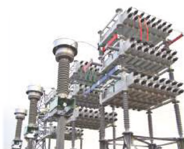
БСК-110-52 УХЛ1, подстанция «Староминская»
